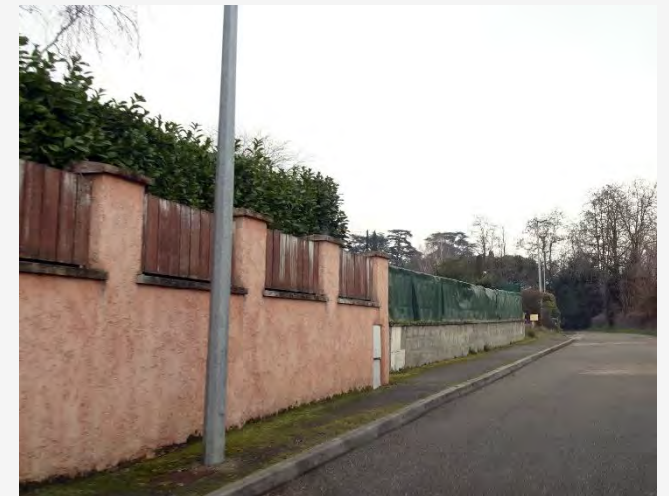
Bâches plastique et parpaings non enduits
